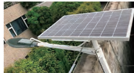
▲ 太阳能LED屋外照明灯
